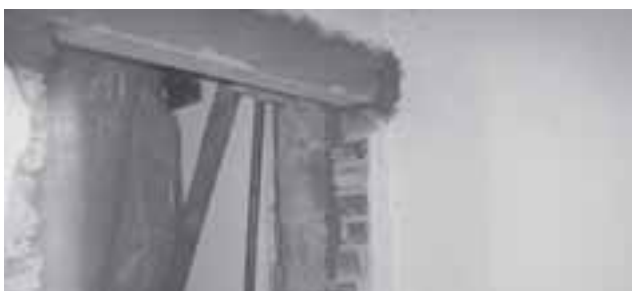
Das Loch ist gebrochen und der Riegel gesetzt
